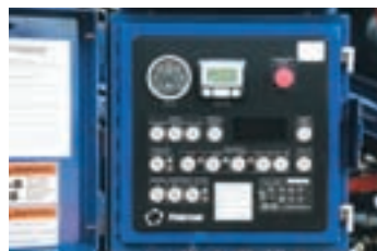
ボタンスイッチの操作パネル
