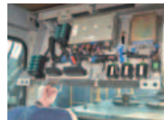
*写真は配電盤ボックスを開けた状態です。
