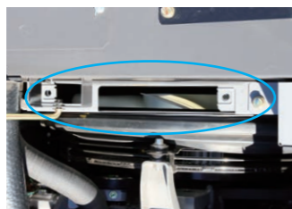
ラジエータ清掃窓
