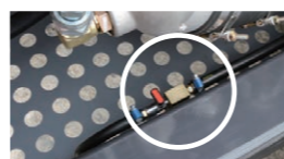
燃料タンクの水抜きコック
