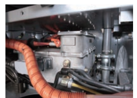
PCU (パワーコントロールユニット)
